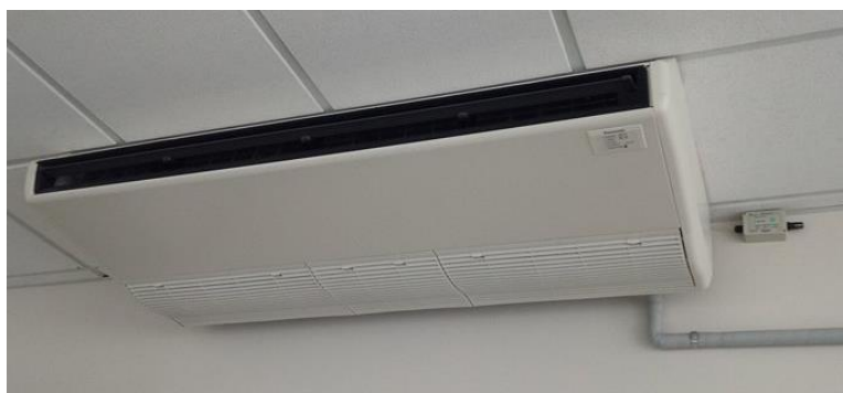
ภาพที่ 20 เครื่องควบคุมอุณหภูมิ
